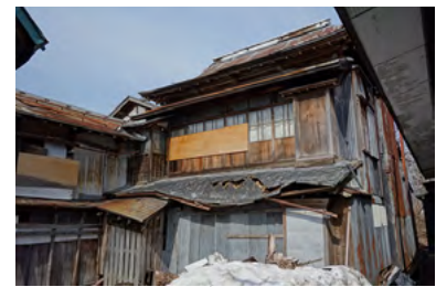
老朽化が著しい建物
