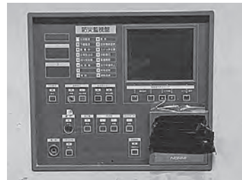
不具合が発生している 体館中の鶴ヶ池荘の消防制御盤
