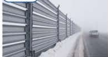
防雪柵は地吹雪による吹きだまりやホワイトアウトなどを防ぎます。
