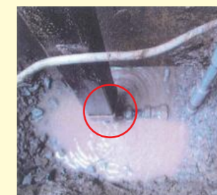
・水抜き栓の不良による漏水
