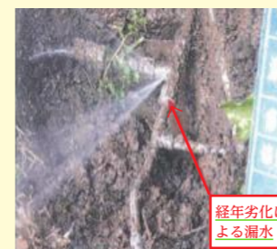
・水道管の老朽化による地下漏水
