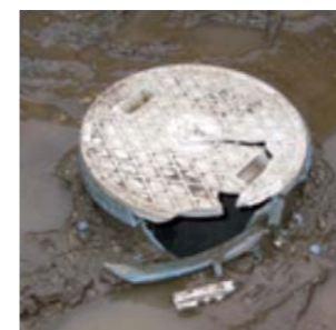
【接続ます破損写真】（イメージ）
