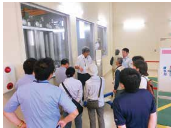
〔大沢第二浄水場膜ろ過室〕
