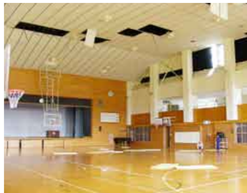
地震によって天井パネルがはがれ落ちた山内小学校体育館内
