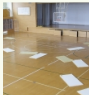
H20.6.14・山内中学校 地震で被害があった体育館
