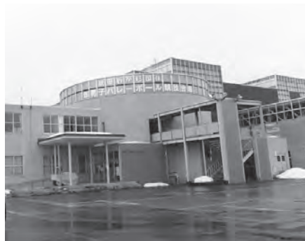
雨漏りがある増田体育館
