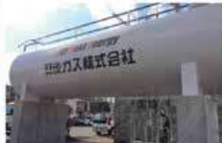
LPガス貯槽
