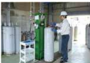
LPガス充填設備
