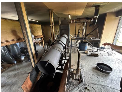
ボイラー設備
