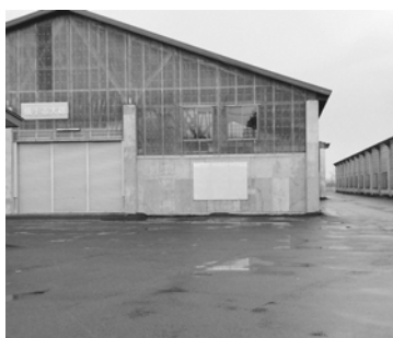
老朽化の進む大雄堆肥センター
