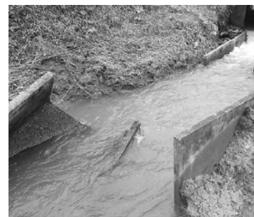
7/24～25の豪雨で 破損した農業用水路
