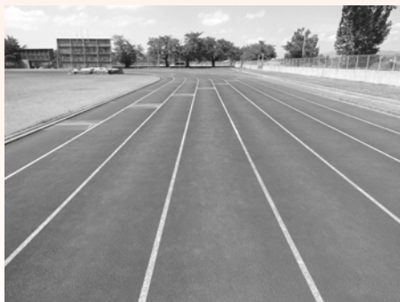
劣化が進む十文字陸上競技場の トラック
