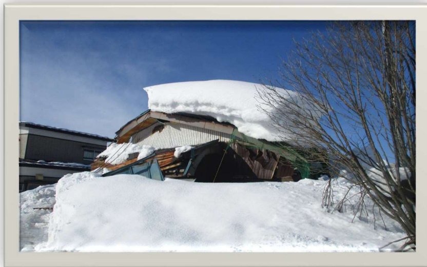
図12-雪の重みにより倒壊した空き家 (令和4年2月撮影) 「相続人不存在の家屋の倒壊」
