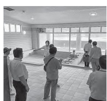
老朽化により、再開するためには多額の改修費が見込まれる鶴ヶ池荘
