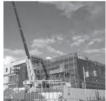
B-1棟に続きは正工事が必要な箇所があると発覚したA棟
