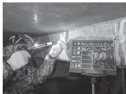
施設内には無数のクラック（ひび割れ）を修復した痕跡が見られた
