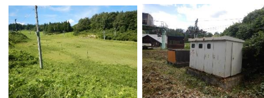
Tバーリフト（停止）・老朽化する受電施設
