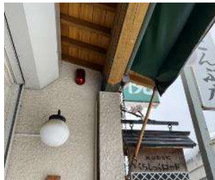
連動型住宅用火災警報器の設置状況
