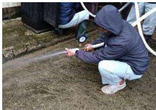
防災設備定期点検の様子
