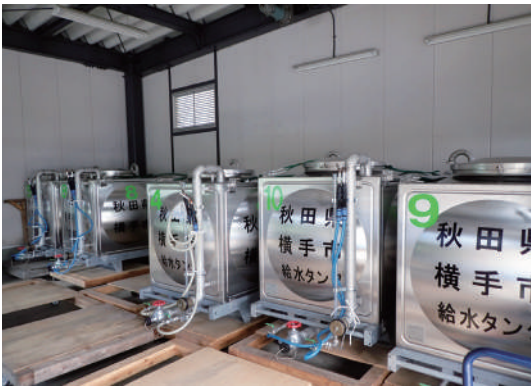
給水タンクの購入(平成24年)
