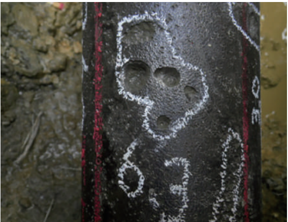
ダクタイル铸铁管の腐食進行
