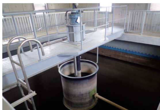
濃縮槽(大沢浄水場)
