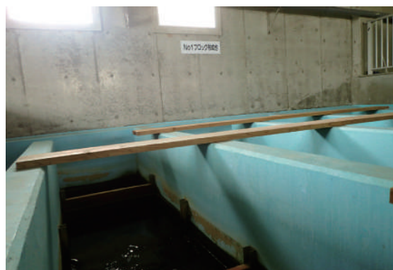
ブロック形成池(大沢浄水場)
