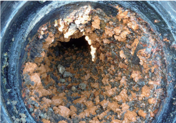
無ライニング铸铁管の内部閉塞状況
