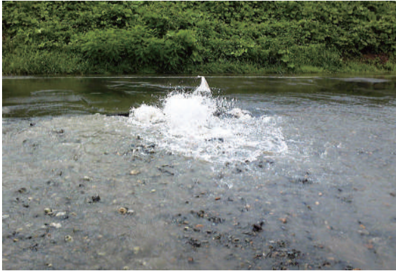
塩化ビニル管の破裂による漏水
