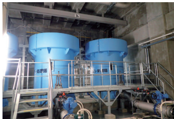
マンガン接触塔(大沢第二浄水場)
