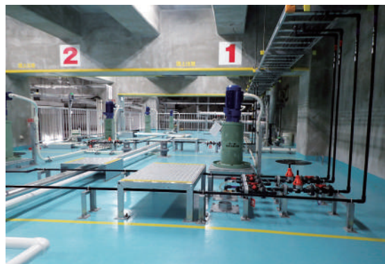
混和池(大沢第二浄水場)
