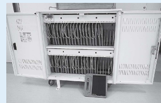
キャビネットを設置し保管・管理
