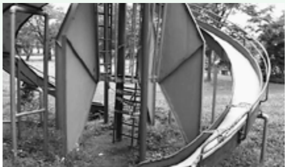
損傷により使用できない遊具
