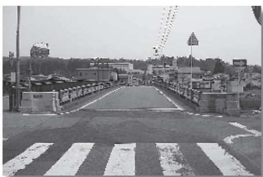
改修が待たれる碓大橋
