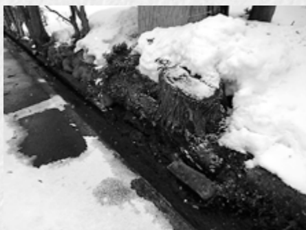
老朽化の著しい融雪側溝(東里地区)
