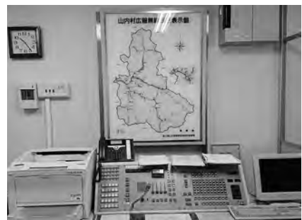
山内地域防災無線放送室
