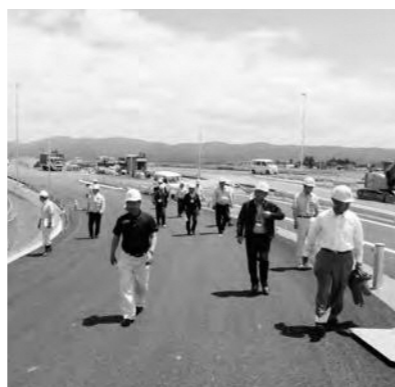
横手北スマートインターチェンジ建設工事現場を視察
