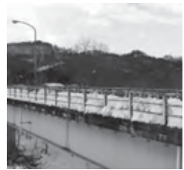
昭和46年に完成し老朽化が進む戸波橋
