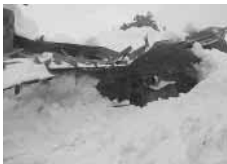
雪の重みで倒壊した建物
