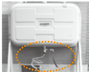
油漏れを防止するために、ホームタンクの配管を確認し、バルブの閉め忘れに注意してください
