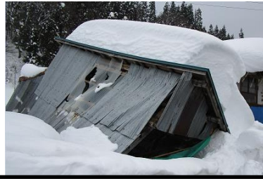
雪害により倒壊した小屋【上平野沢区】
