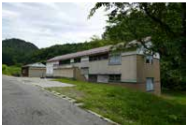
金麓第一SS格納庫兼防除作業用水圧送ポンプ場
