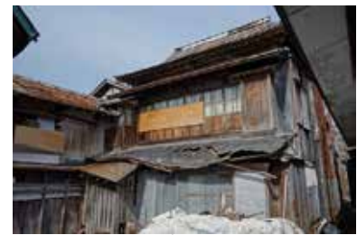
老朽化が著しい建物
