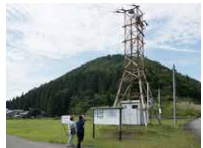
鉦山の送電施設
