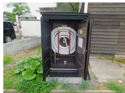
易操作性消火栓の設置状況
