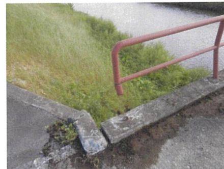
防護柵の損傷
