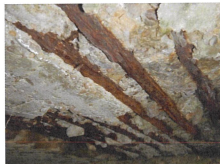
床版の鉄筋露出
