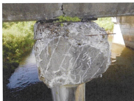
橋脚の遊離石灰を伴うひびわれ、剥離
