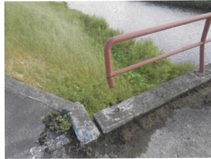
防護柵の損傷
