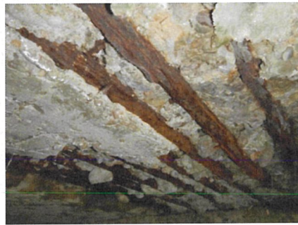
床版の鉄筋露出
