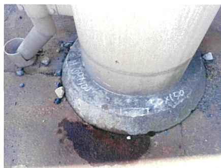
根巻きコンクリートの剥離 (横断歩道橋)
