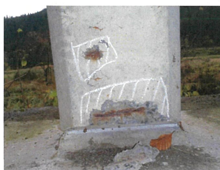
柱の鉄筋露出 (スノーシェッド)
