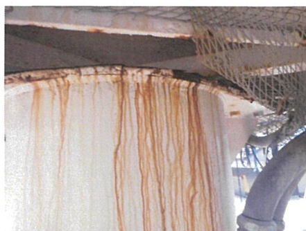
橋脚の腐食 (横断歩道橋)
