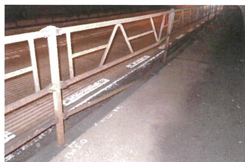
ガードパイプの破損・変形
