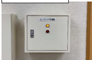
ルーフヒーター制御盤
