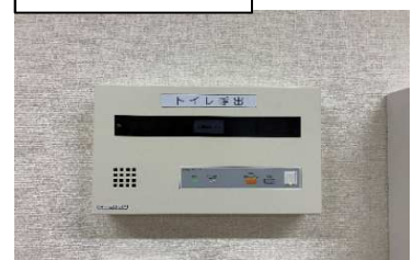
トイレ呼出表示器
