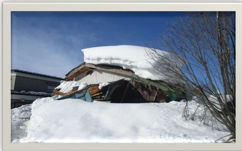
図1 2-雪の重みにより倒壊した空き家 (令和4年2月撮影) 「相続人不存在の家屋の倒壊」
