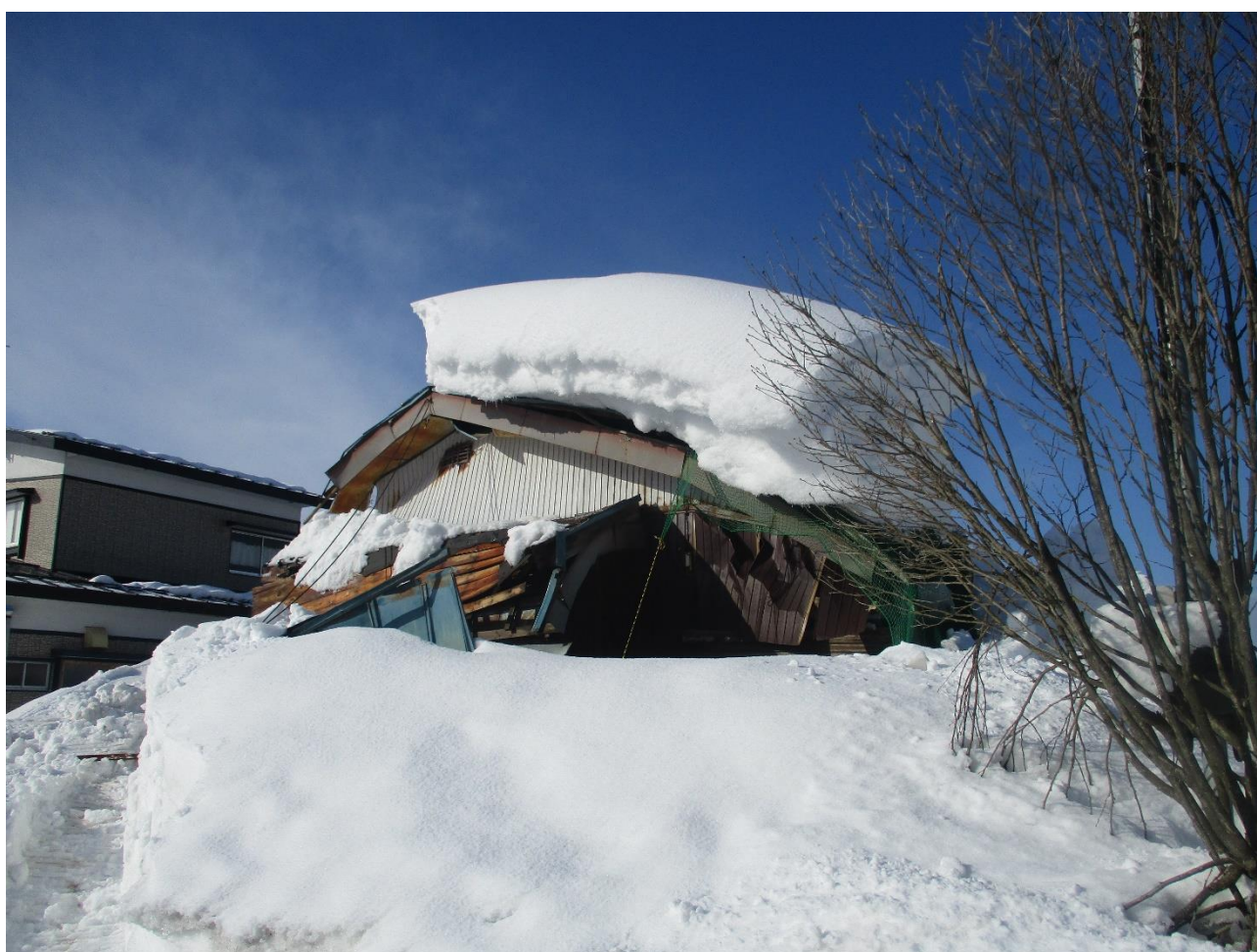
図1-3 一雪の重みにより倒壊した空き家 (令和4年2月撮影) 「相続人不存在の家屋の倒壊」
