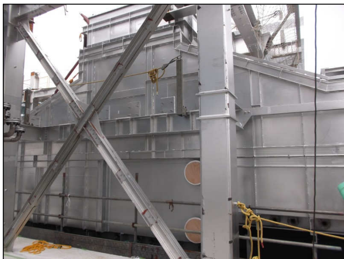
熱回収施設内に設置されたストーカ炉
