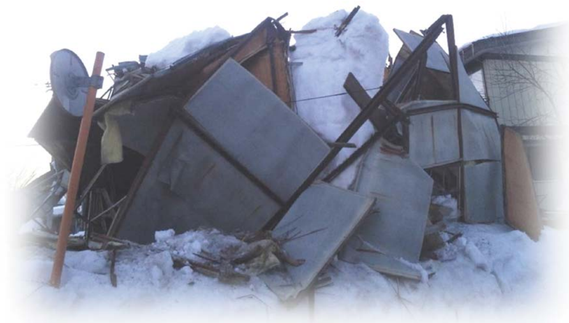
雪の重みで倒壊した家屋
