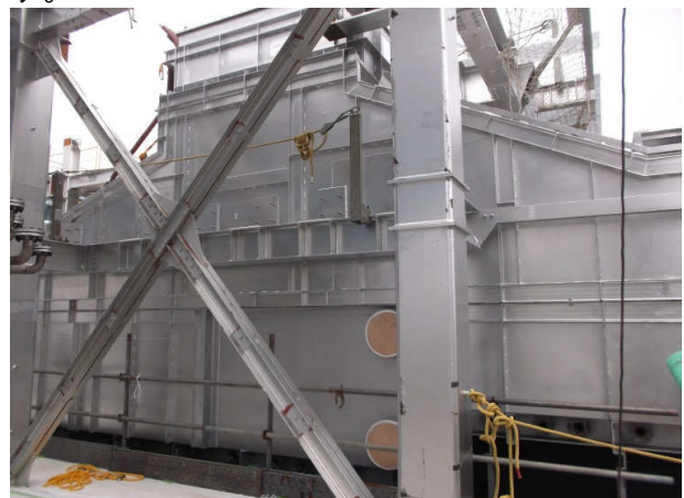
クリーンプラザよこてに設置された焼却炉
